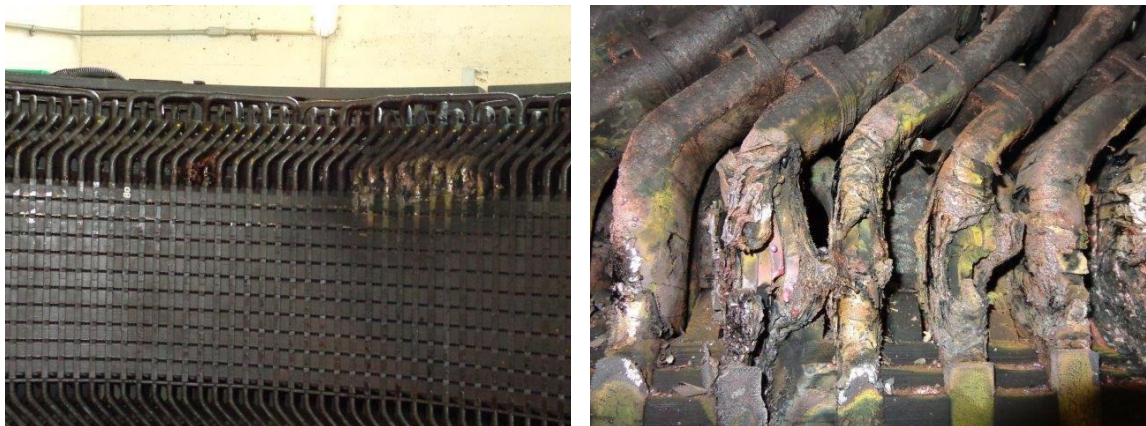
FIGURA 3 – Avarias nas Cabeças Bobinas do Estator Máquina 2
