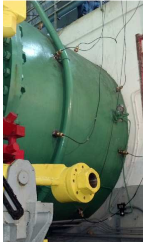
Figura 8 – Caso C - Sistema de medição de vazão acústico do tipo intrusivo instalado próximo à válvula borboleta de uma turbina Francis.
