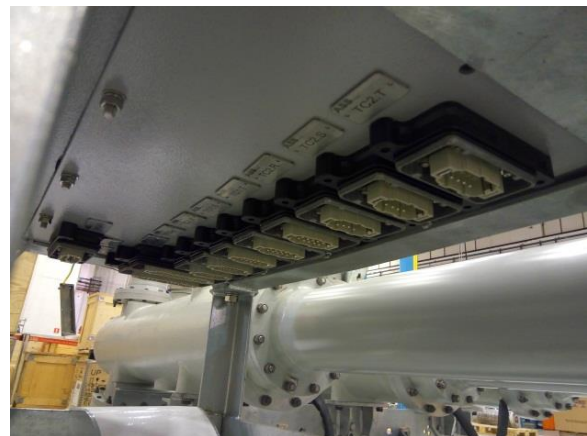
Fig. 16: Vista inferior do cubículo de controle, com os terminais de fixação dos cabos
