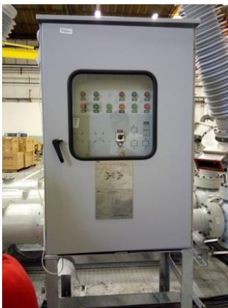
Fig. 15: Cubículo central de controle (CCC)
