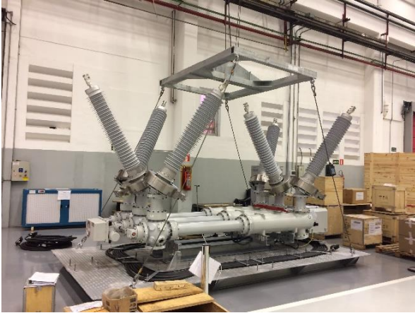
Fig. 7: Detalhe do içamento, mostrando a cruzeta dedicada e seus cabos, com o módulo compacto ainda no solo
