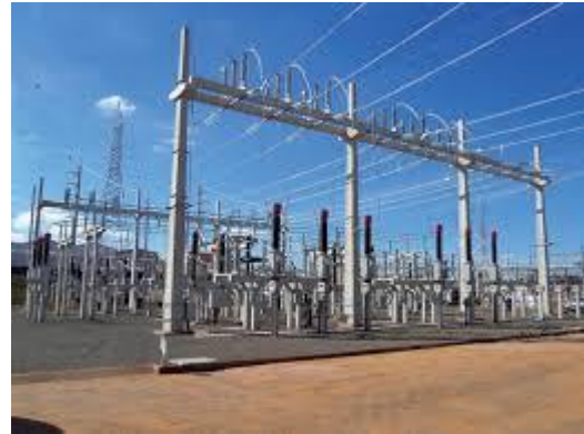
Fig. 19: Entradas de linhas de transmissão, com estruturas em concreto
