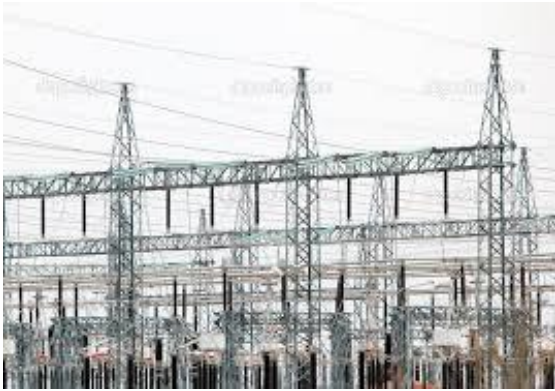
Fig. 18: Entradas de linhas de transmissão, com estruturas metálicas
