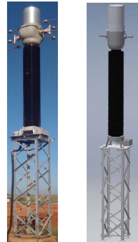
Figura 1: Transformador de Corrente 500 kV em campo e modelado pela metodologia BIM
