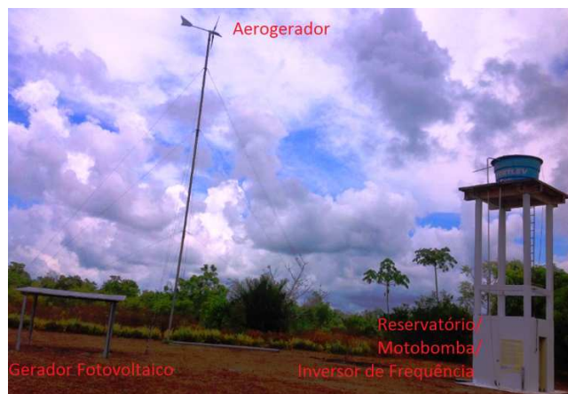
FIGURA 8 – Sistema híbrido solar-eólico instalado em Itauba-AP
