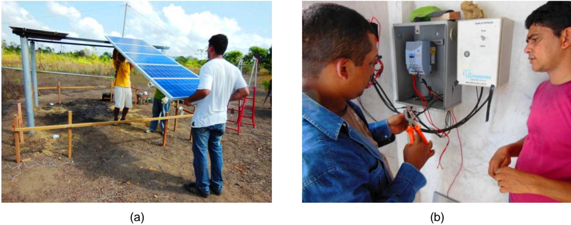
FIGURA 7 – Montagem e instalação do (a) gerador fotovoltaico e (b) inversor de frequência.
