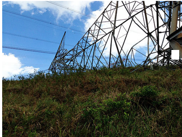
FIGURA 5 – Foto mostrando uma das torres da LT 500 kV Adrianópolis-Resende derrubada por uma tempestade severa no 18 de outubro de 2013 por volta das 23:16 UT.
