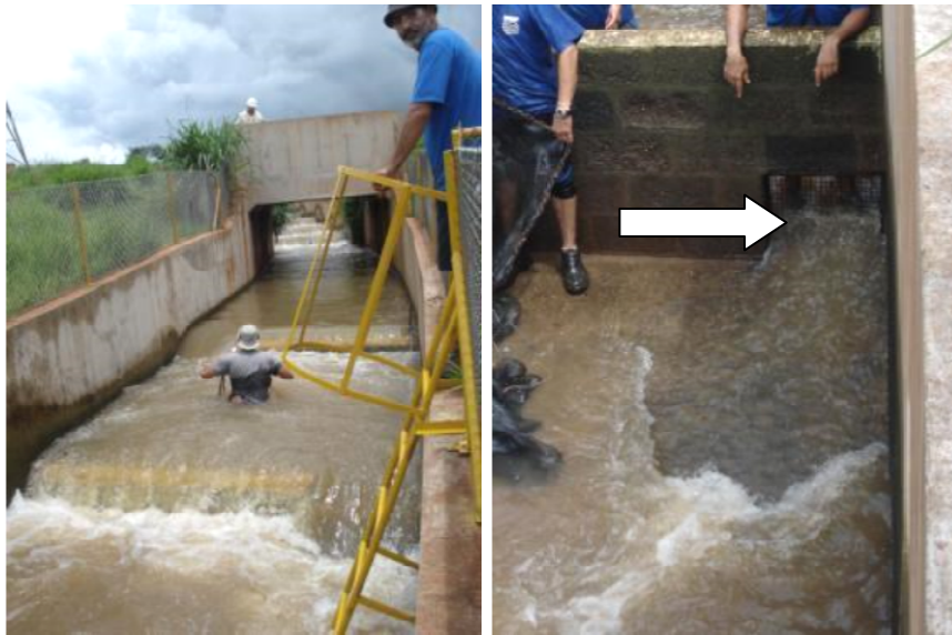
Figura 1 – Colocação de grades para seccionamento das escadas para peixes na PCH Palmeiras com nível normal de água, detalhe da grade de seccionamento com nível baixo de água.
