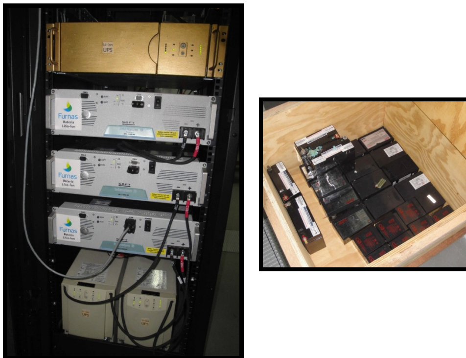
Figura 7: Sistemas UPS modificados para operarem com baterias de lítio-íon (esq) e as baterias de chumbo que foram substituídas (dir).
